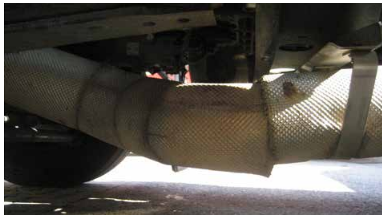
Неприемливи състояния: счупени изпускателни тръби, повредена изолация, дълбоки драскотини, вдлъбнатини, намаляващи диаметъра на изпускателните тръби.
