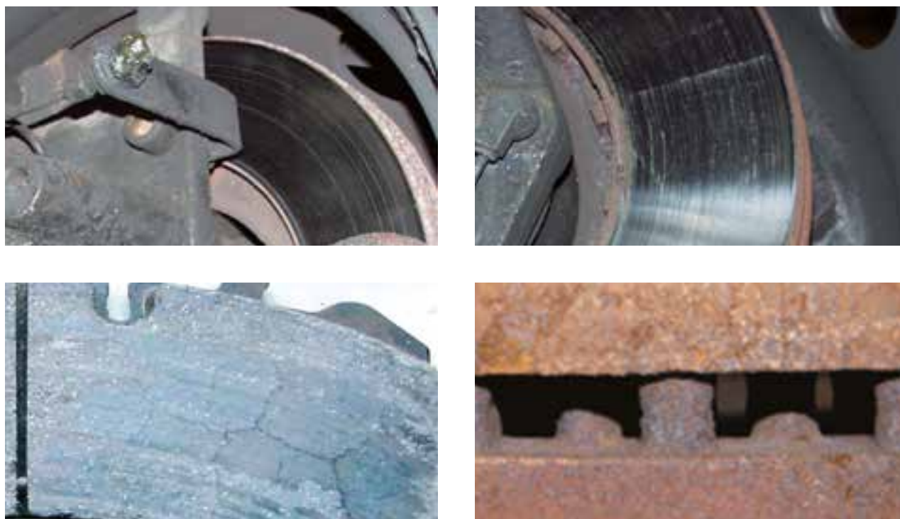
Нормално състояние в съответствие с възрастта и пробега на автомобила Дебелина на спирачните накладки > 30 %
