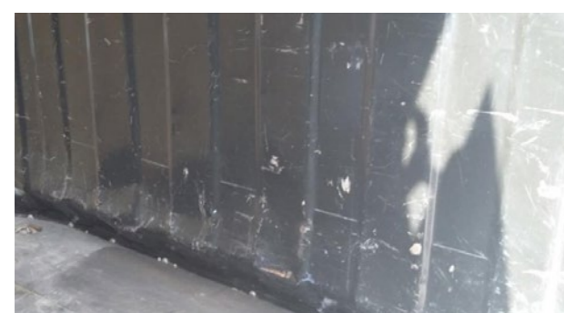
Вътрешни деформации: слаби деформации без перфориране или срязване, продължителност на ремонта \leq 3 h
