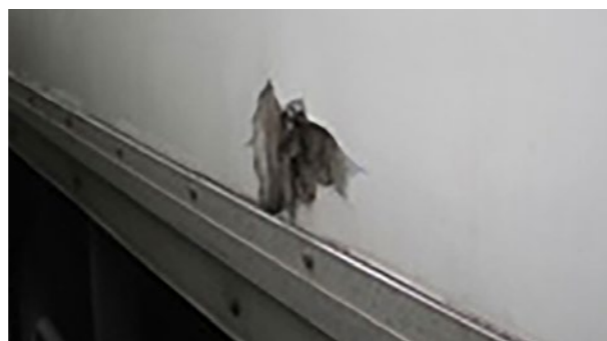
Дървени странични панели: повреди по дървените опори с дължина \geq 20 cm
