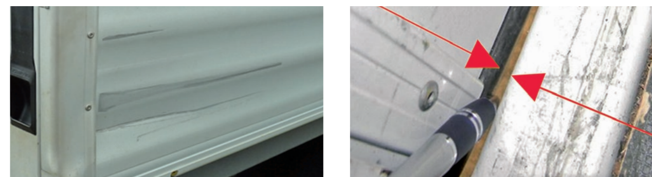
🔄 Деформирани метални елементи, чийто ремонт е икономически изгоден, канатът не се затваря или пропуска пясък
